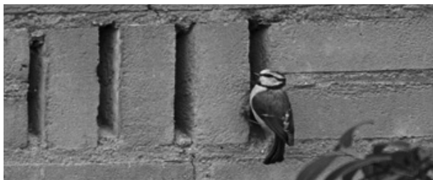
Pimpelmees bij spouwmuur ventilatie
